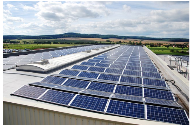
PV-Anlage im Gewerbegebiet Marksuhl, © ruhlamat GmbH
